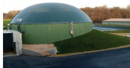
← Unité de méthanisation à la ferme. ©CRA NA
