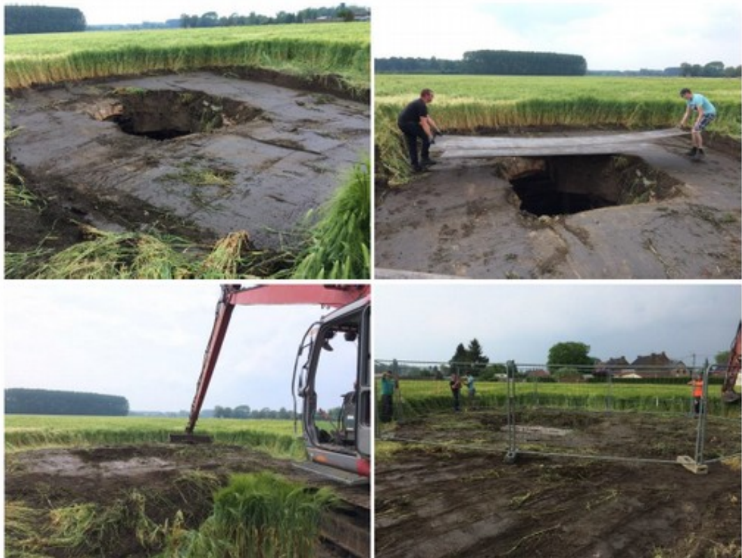
Figure 5 - Mesures de sécurité publique prises aux abords du puits (Photos UTAM Est).
