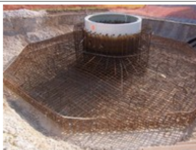
Photo n°5 : éolienne en cours de construction : la fondation s'arrête à un mètre en dessous du niveau du sol et est ensuite recouverte de terre.
