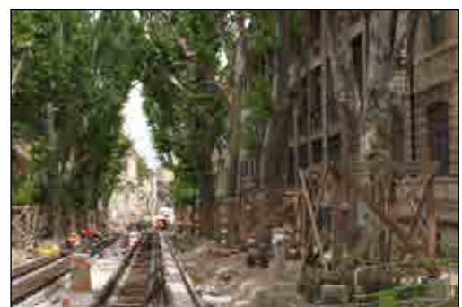
Fig. 5 - Protection des arbres lors de travaux sur voirie (A. Micand, Plante & Cité)
