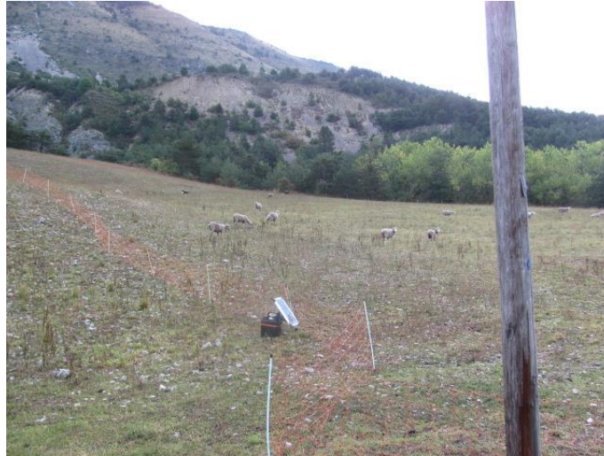
Batterie sur poste solaire d'un parc de regroupement
